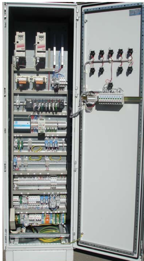
Рис.9. Внешний вид шкафа управления порталом
